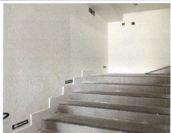
Sinalização e combate a incêndio, escada.
