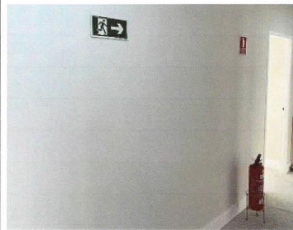
Sinalização e combate a incêndio, circulação de gabinetes, térreo.
