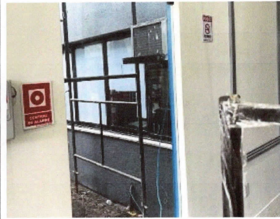
Sinalização e combate a incêndio, central de alarme, recepção, térreo.
