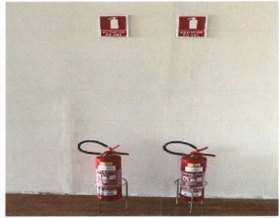
Sinalização e combate a incêndio, recepção, superior.
