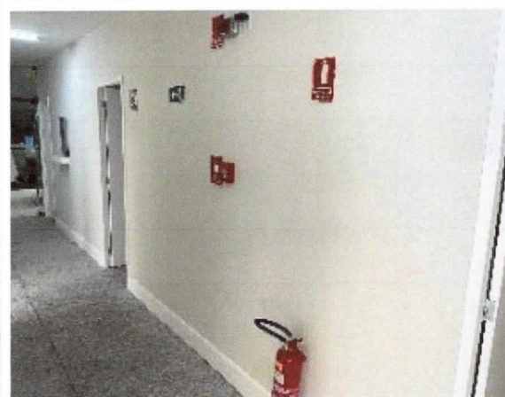
Sinalização e combate a incêndio, circulação de gabinetes.
