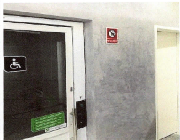
Sinalização e combate a incêndio, elevador PNE, térreo.
