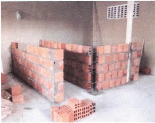
Alvenaria de vedação de blocos cerâmicos furados na horizontal de 9x19x29 cm (espessura 9 cm), cozinha.
