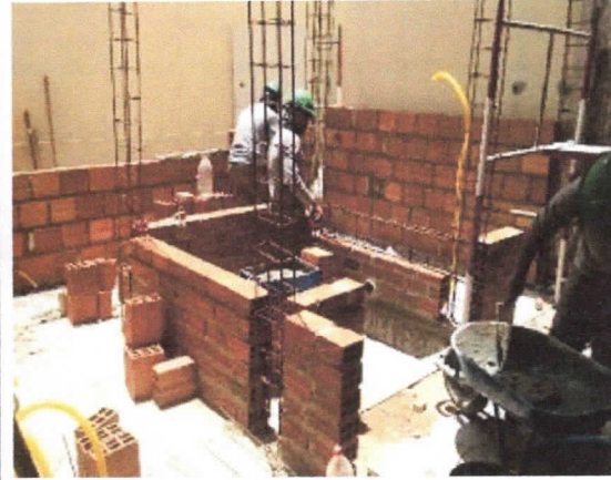
Alvenaria de vedação de blocos cerâmicos furados na horizontal de 9x19x29 cm (espessura 9 cm), escada.
