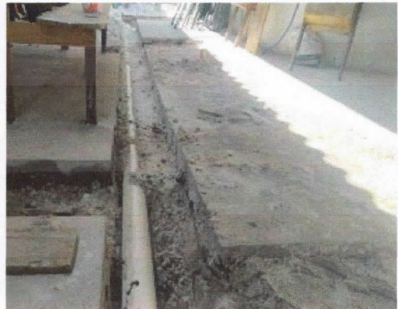
Esgoto sanitário, lançamento de tubos de pvc 100mm, rede de coleta banheiro PCD superior
