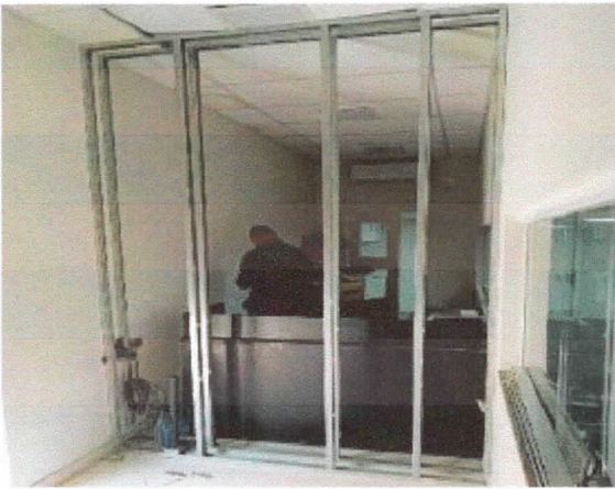
Elevações, montagem de estrutura parede drywall, sala de áudio e vídeo plenário.
