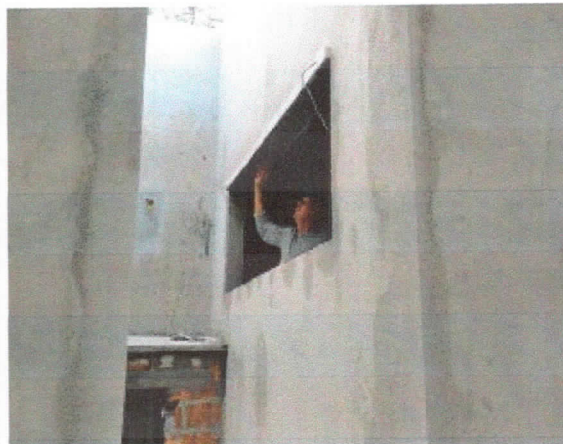
Revestimentos, reboco e regularização de vãos de janela cozinha e casa de gás.
