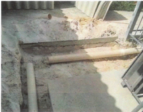
Esgoto sanitário, lançamento de tubos de pvc 100mm, rede de coleta banheiro PCD superior
