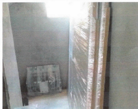
Elevador PNE, estrutura da cabine.
