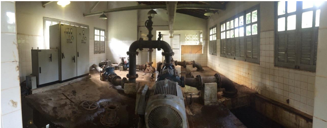
Figura 8.15: Vista do interior da Estação elevatória de água bruta da Ribeira
