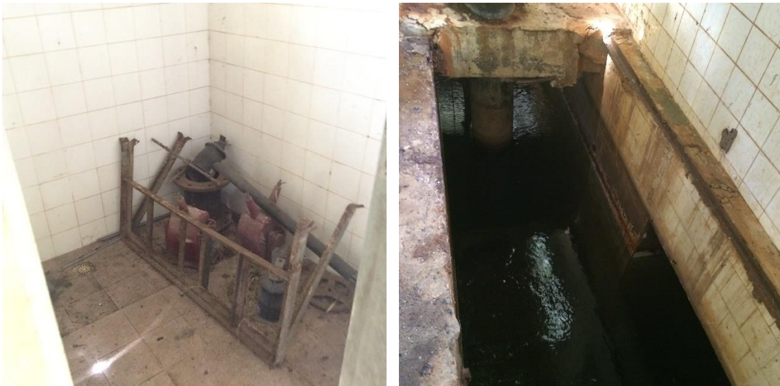
Figura 8.16: Material disposto de forma insegura e Poço de sucção das bombas em péssimo estado de conservação
