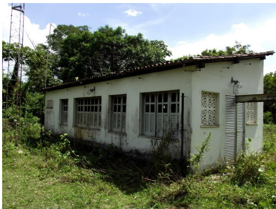
Figura 8.13: Casa de Bombas vista 1
