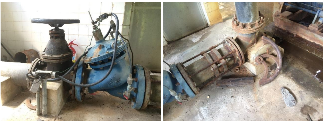
Figura 8.18: outras imagens no interior da estação elevatória de água bruta Ribeira
