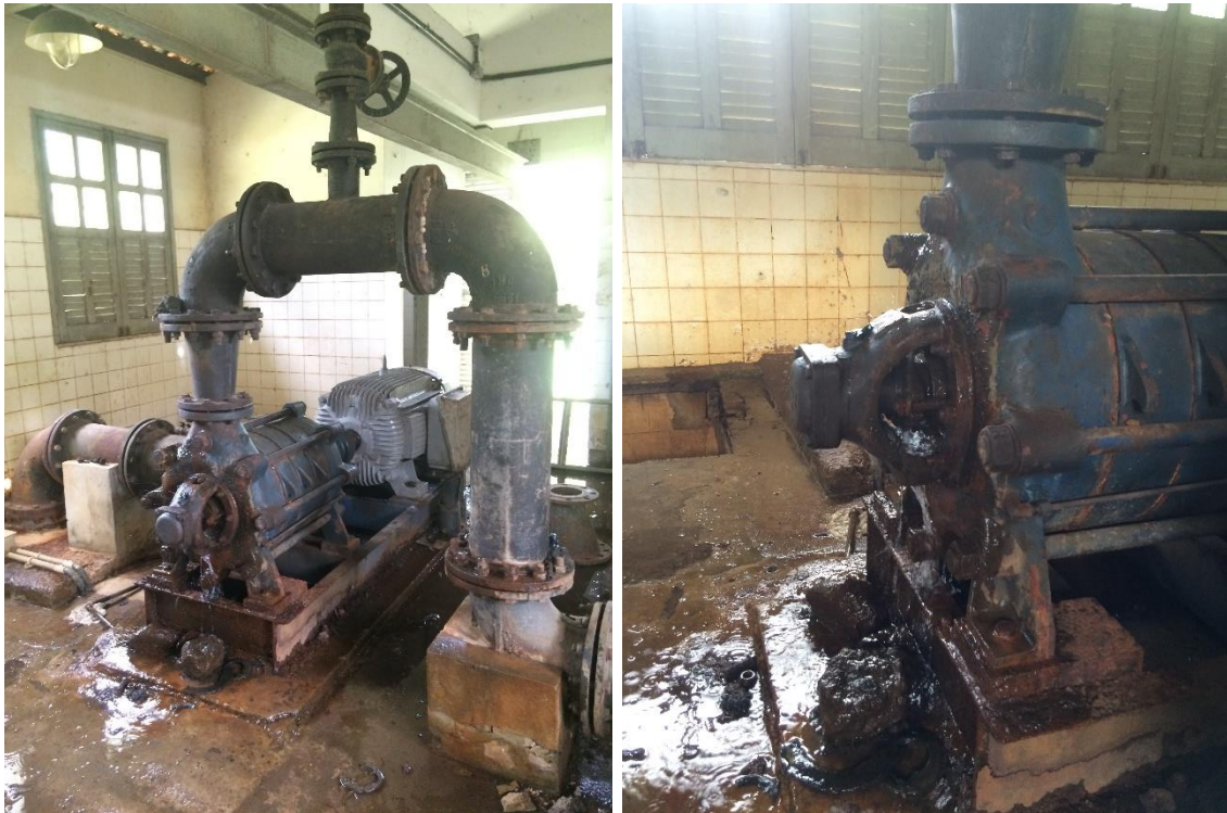
Figura 8.17: Bomba em operação apresentando vazamento
