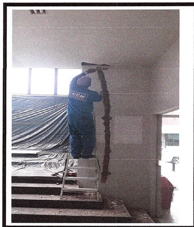
FOTO 02 – Rasgo em alvenaria
